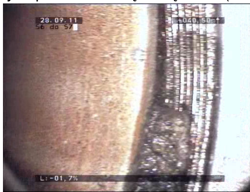
Fot. 8 Infiltracja przez złącze rur
