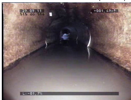
Fot. 33 Niewielkie podtopienie kanału
