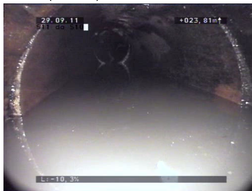
Fot. 23 Nie osiowe ułożenie kanału
