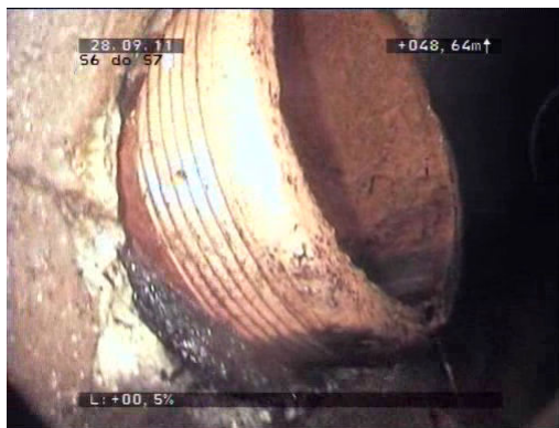
Fot. 9 Infiltracja wód gruntowych w miejscach nieprawidłowo włączonych przykanalików
