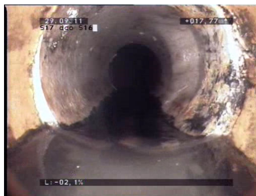
Fot. 35 Zaniżenie rur
