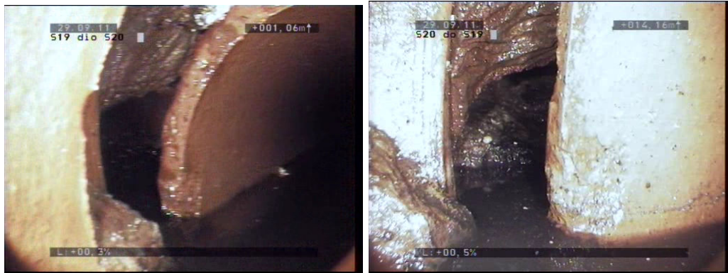
Fot. 45 Ubytki konstrukcji w złączach rur, widoczne pustki na zewnątrz
