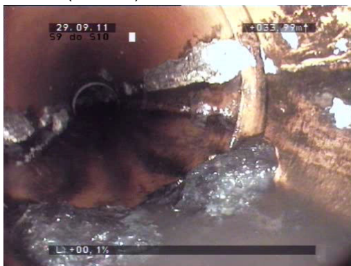
Fot. 19 Osady twarde na złączu rur
