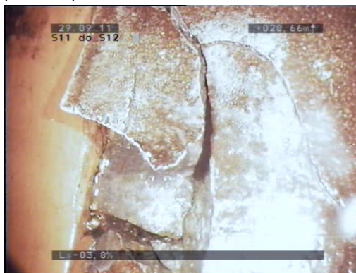
Fot. 26 Ubytek konstrukcji w złączeniu rur
