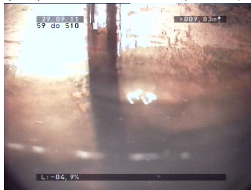
Fot. 15 Nieszczelne połączenie rur
