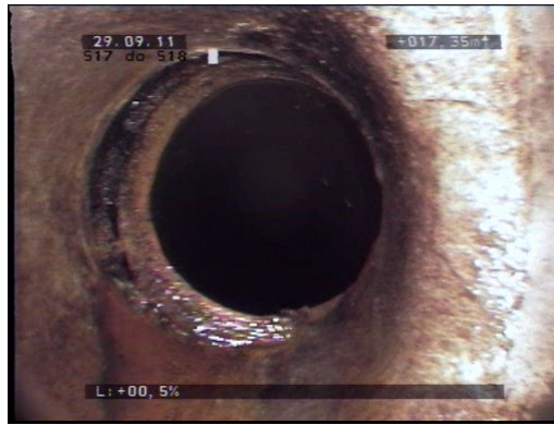
Fot. 37 Infiltracja wód gruntowych na połączeniu przykanalika z trójnikiem
