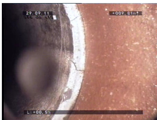
Fot. 31 Pęknięcia podłużne rury
