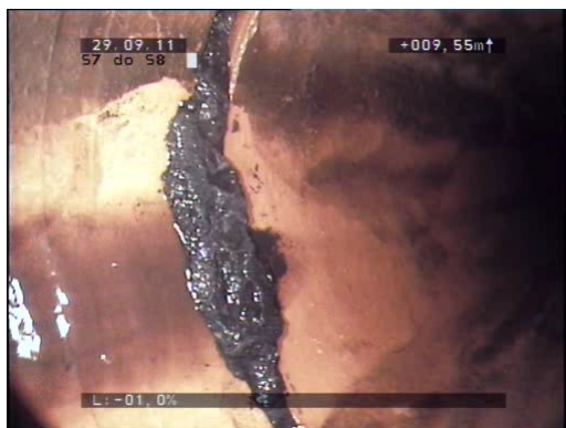
Fot. 11 Nieszczelne złącze rur
