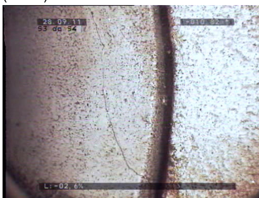
Fot. 5 Pęknięcie ukośne rury
