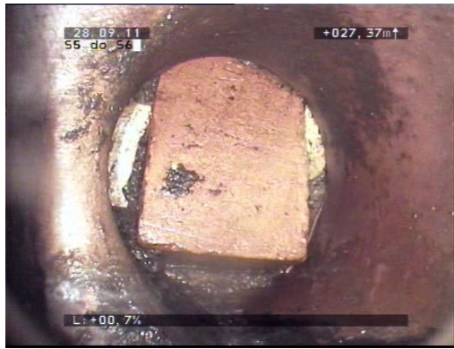
Fot. 7 Nieprawidłowo uszczelniony trójnik
