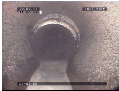
Fot. 22 Przesunięcie poprzeczne rur
