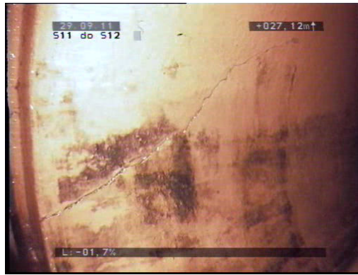
Fot. 25 Pęknięcie podłużne rury
