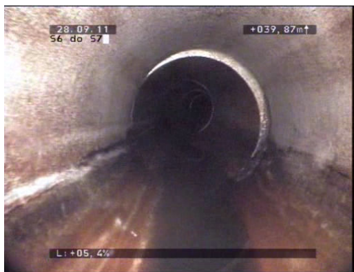
Fot. 10 Nie osiowe ułożenie kanału
