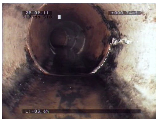
Fot. 42 Nie osiowe ułożenie kanału
