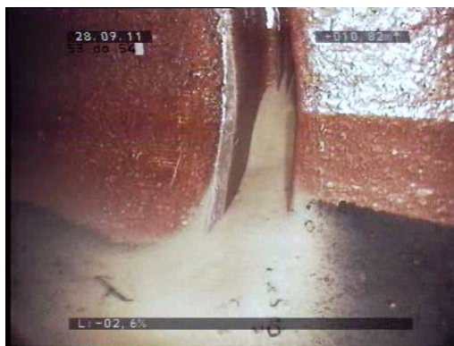
Fot. 4 Infiltracja wód gruntowych wraz z gruntem
